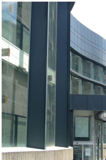
Source PPG France – TNB de Rennes Peinture intumescente sur poteaux soumis aux intempéries R60.
