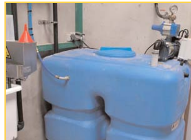
Cuve de stockage d'eau
