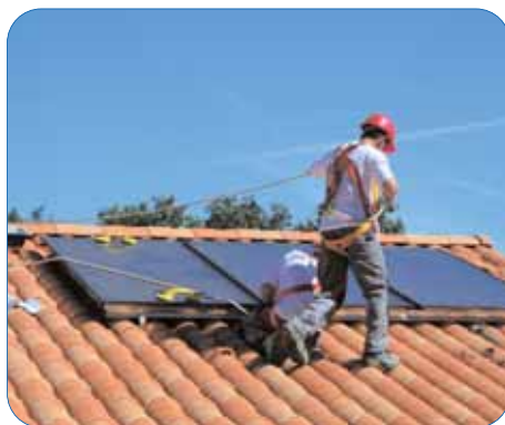
Placement des capteurs
