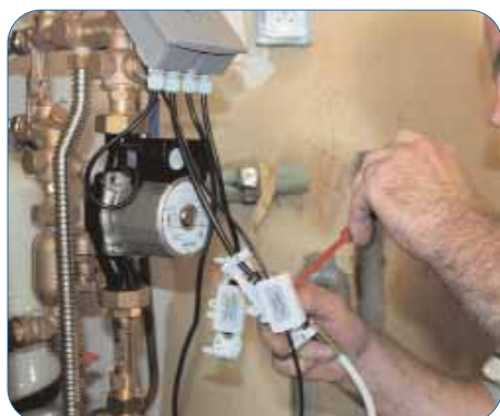
Raccordement du câble d'alimentation ACI
