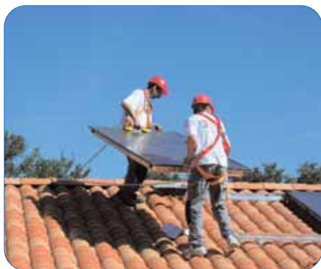
Placement des capteurs
