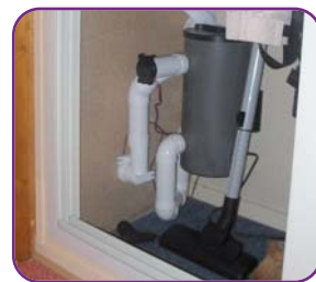
exemple d'installation de la centrale dans un placard du hall d'entrée
