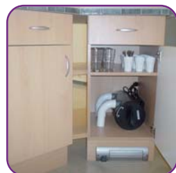
exemple d'installation de la centrale dans un placard bas de la cuisine
